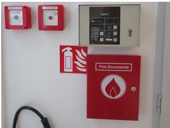
Foto 14 – Tlačítka central stop, total stop, OPPO (obslužné pole PO) a připravená schránka na DZP (nad PHP) poblíž jídelny v pavilonu E
