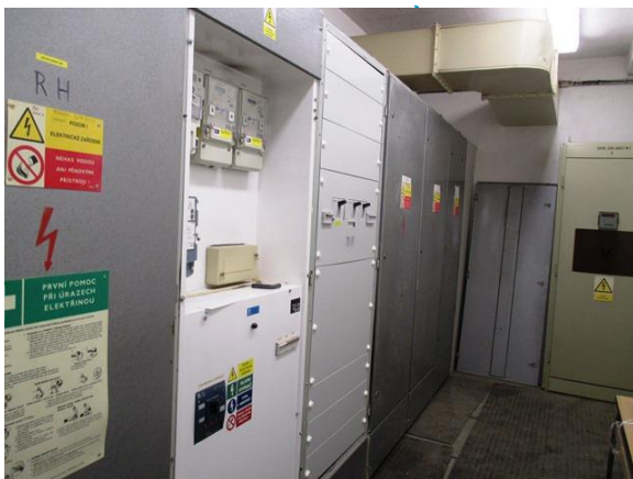
Foto 16 – Hlavní el. rozvaděč
