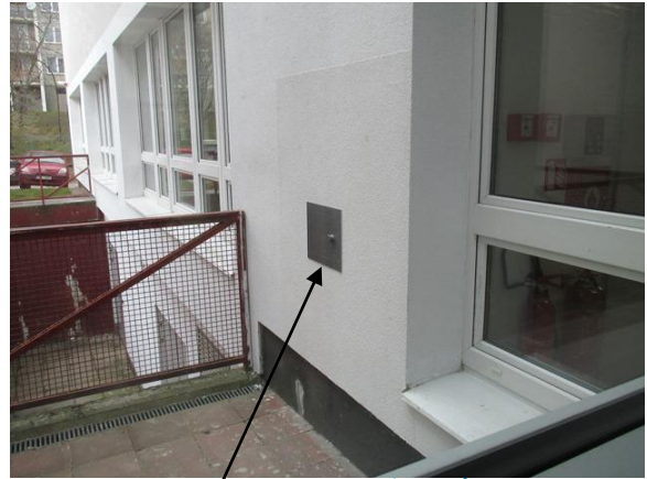
Foto 13 – KTPO (klíčový trezor požární ochrany) na fasádě pavilonu E
