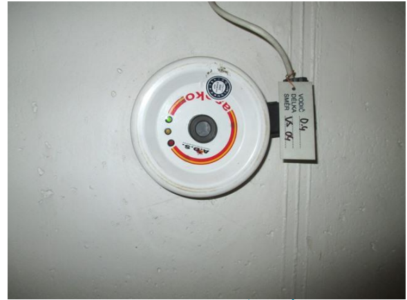
Foto 27 – Detekce oxidu uhelnatého (CO) v podzemních garážích
