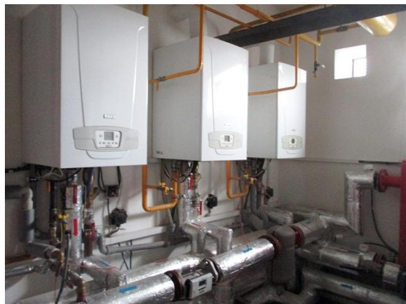
Foto 6 – Plynová kotelna ve střešní přístavbě domu A
