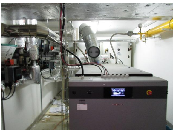
Foto 7 – KGJ (kogenerační jednotka) v 1.PP domu B
