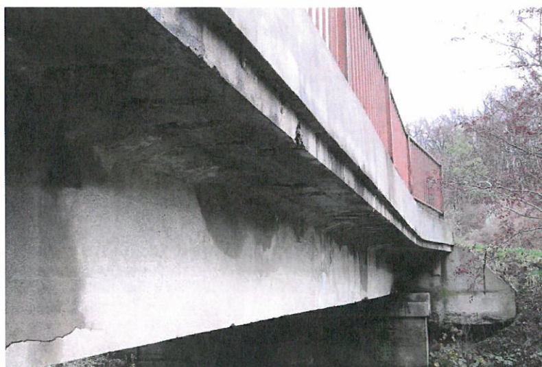
Zatékání na bok nk na návodní straně.
