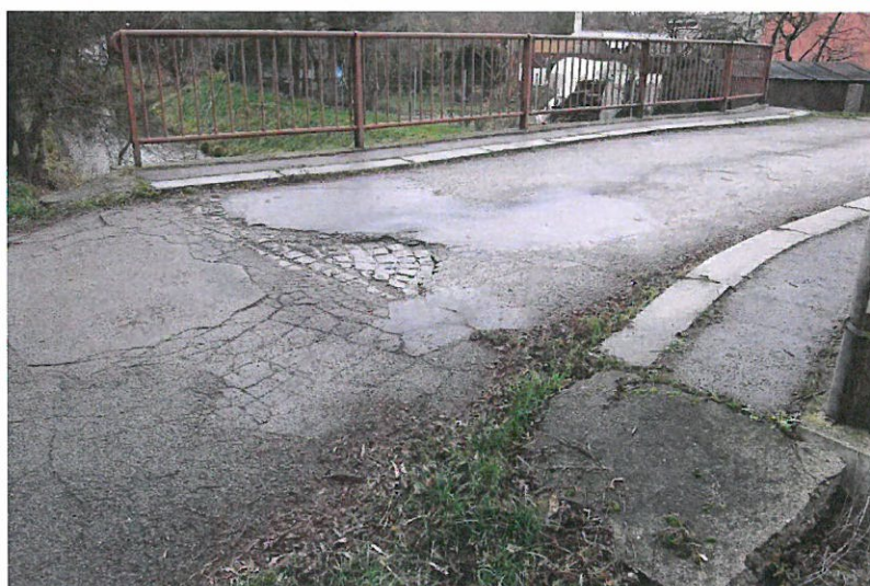
Předmostí na levém břehu s porušenou převrstvenou vozovkou.
