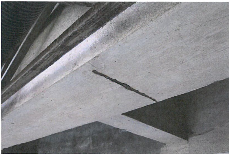
Detail koroze podkladní výztuže.
