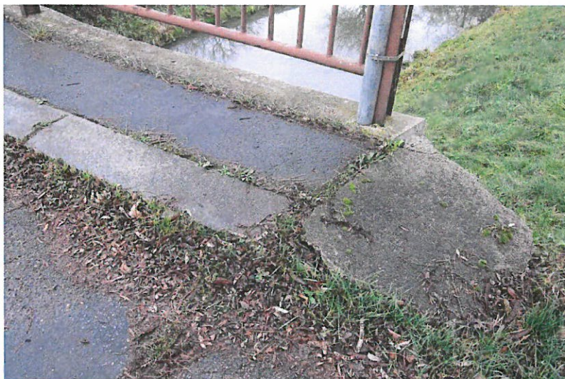
Detail přechodu obslužného chodníku na předmostí na povodní straně mostu nad pravobřežní opěrou.
