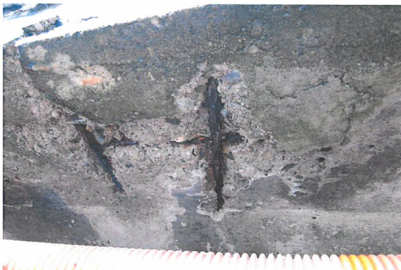
Koroze výztuže na podhledu konzoly na povodní straně nk.
