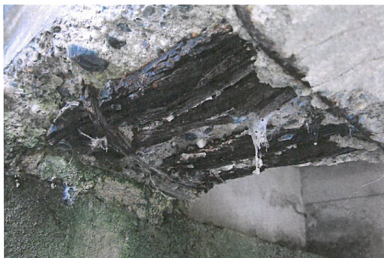
Detail koroze výztuže krajního trámu na povodní straně u pravobřežní opěry.
