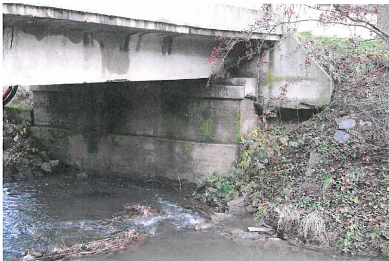
Pravobřežní opěra s podemletým návodním křídlem.
