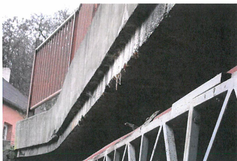
Zatékání pod římsou na povodní straně mostu.
