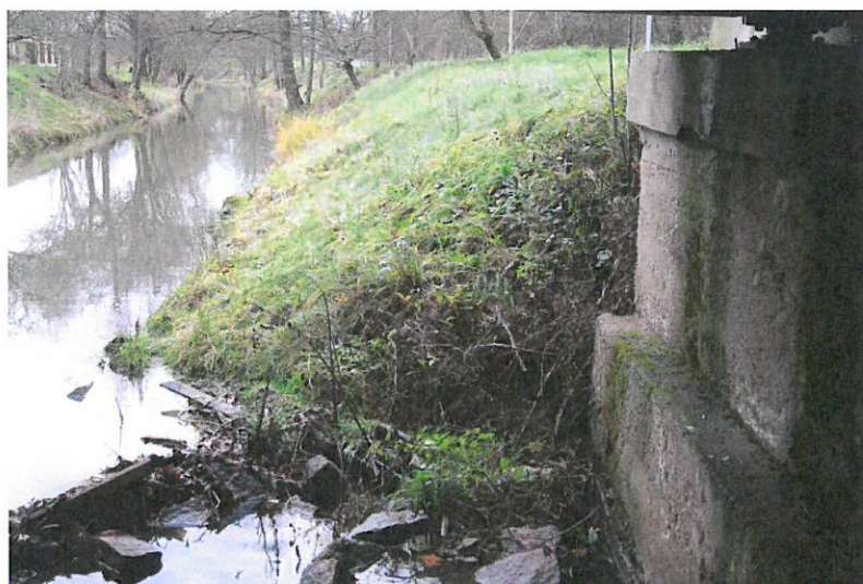
Naplaveniny u pravobřežní opěry.
