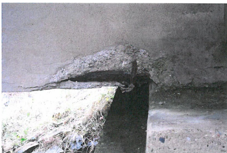
Koroze výztuže krajního trámu nk na návodní straně u pravobřežní opěry.
