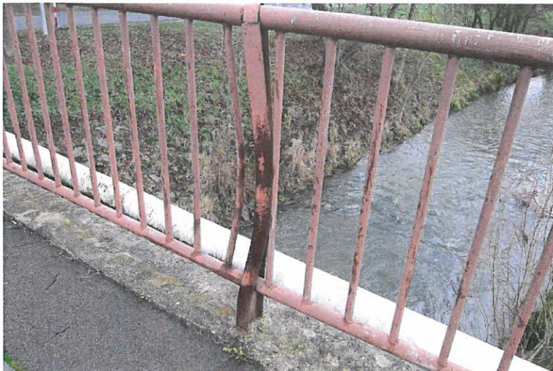
Deformované a zkorodované zábradlí na povodní straně mostu.
