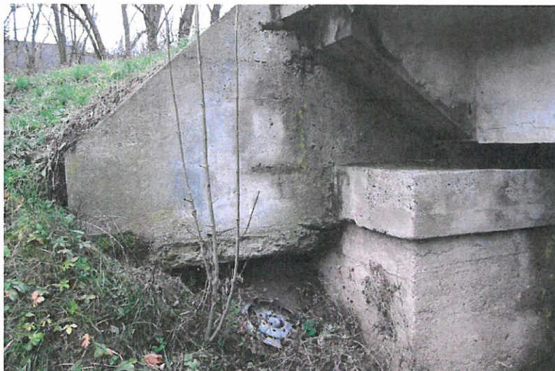
Podemleté křídlo na návodní straně levobřežní opěry.
