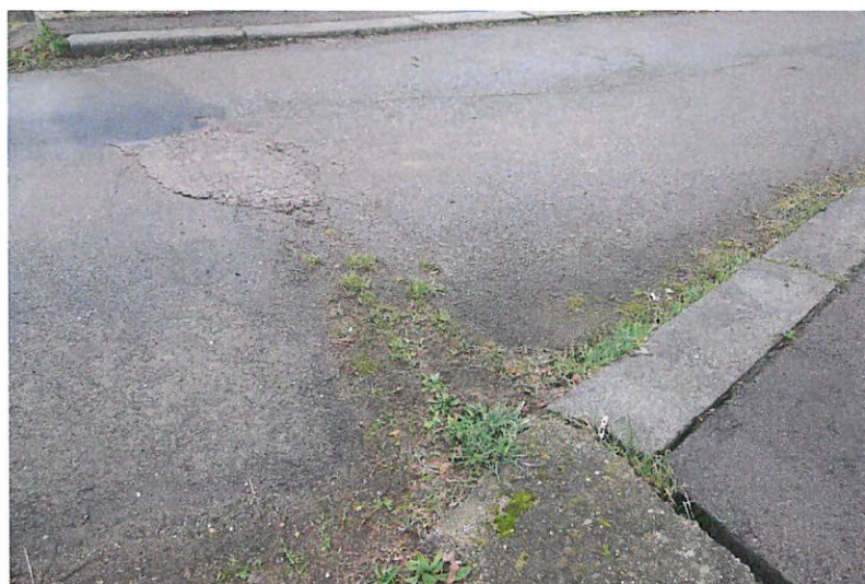
Trhliny v obslužném chodníku a ve vozovce nad pravobřežní opěrou.
