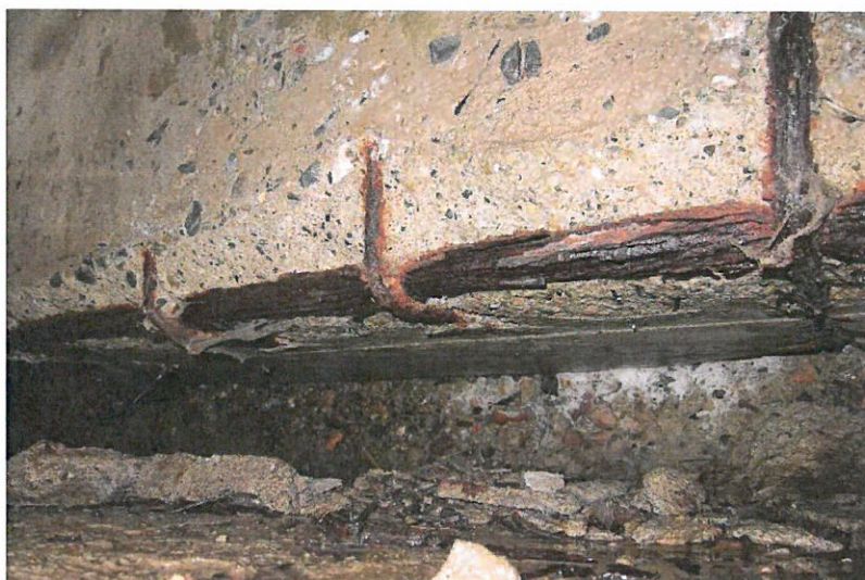
Detail koroze výztuže podporového příčnicku na levobřežní opěře.
