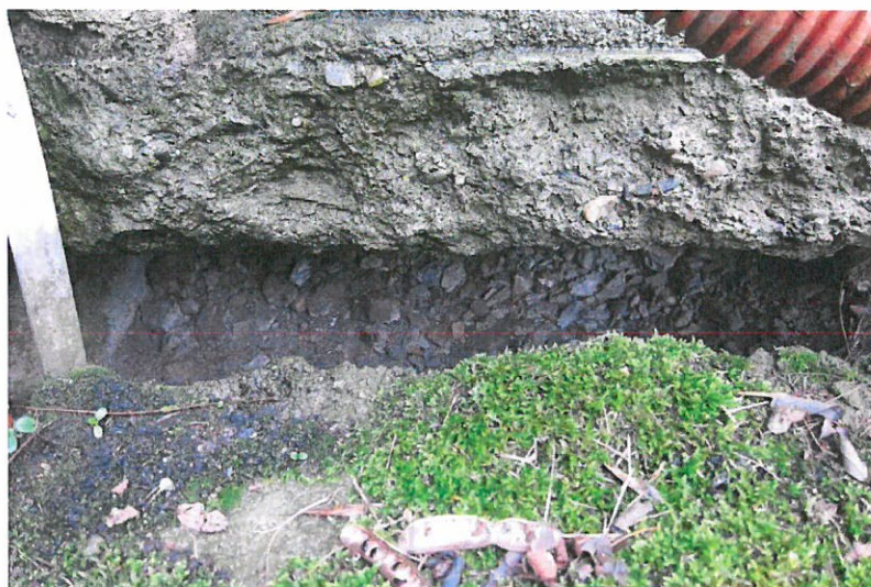
Kaverna pod povodním křídlem na levé straně mostu.
